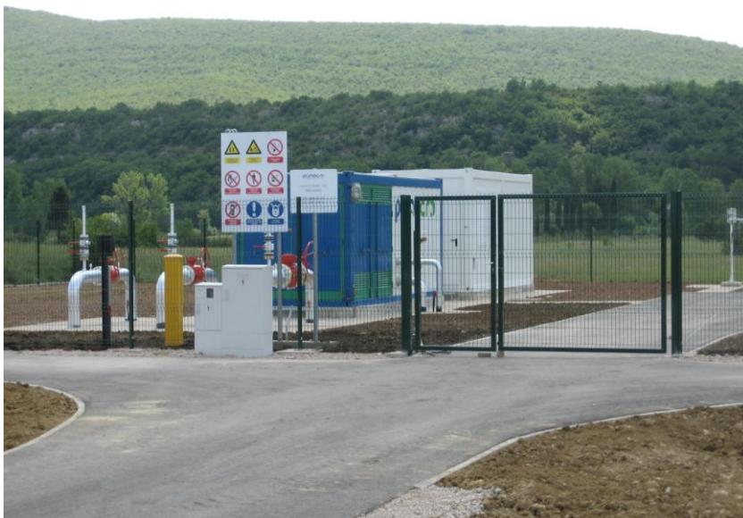
Slika 14 - Tipična kontejnerska mjerno-redukcijska stanica
